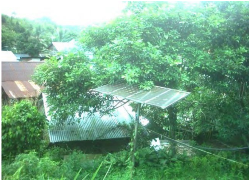
Gambar 4.1: Panel Solar fotovoltan (Sumber Penyelidik)
